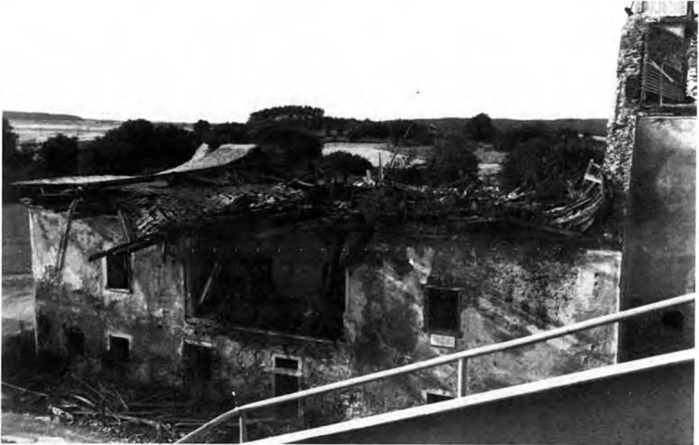
Abb. 34: Der Dürnhof nach dem Dacheinsturz am 27. Juli 1976
