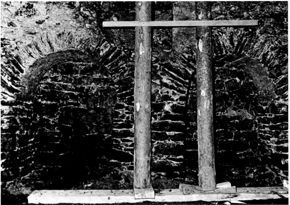
Abb. 18. Details aus dem Inneren des Südtraktes (Tor- und Wohnbau) der ehemaligen Kuenringerburg auf dem Propsteiberg Zwettl
